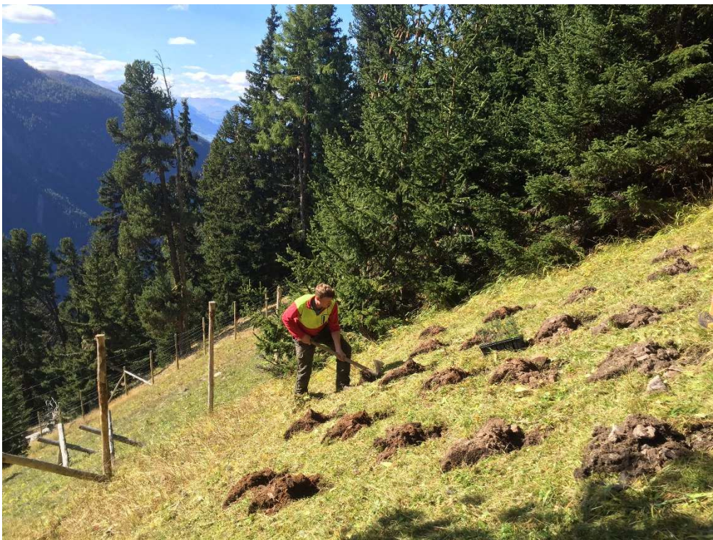
Bild Forst- Werkbetrieb Albula 2015: Pflanzarbeit am Cuolm da Latsch in Bergün zur nachhaltigen Sicherung der Schutzfunktion
