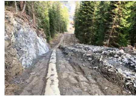
Die Druckleitung in Richtung Zentrale Preda
