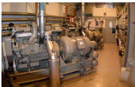
Maschinenraum Dieselmotoren in Alvaneu
